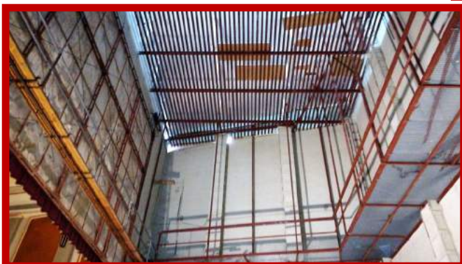
En la part superior es veu el nou peine de ferro de la tramoia. En la part inferior, la nova passarel·la metàl·lica que permet circular per tot el perímetre de l'escenari.
