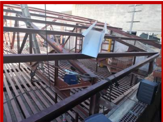
Estructura de ferro de la coberta amb el nou peine també de ferro en la part de baix.
