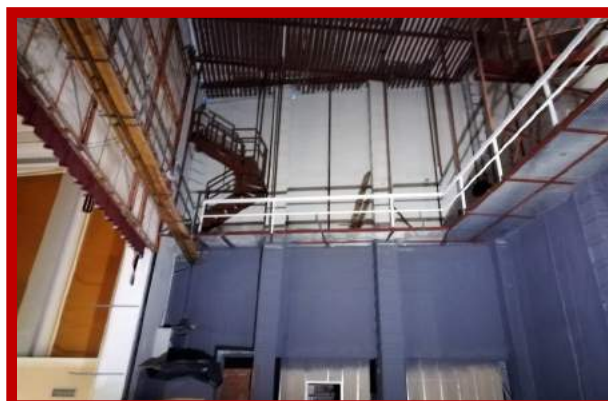
Passarel·la que comunica amb l'escala de ferro (esquerra) per a accedir al sostre del pati de butaques i amfiteatre.
