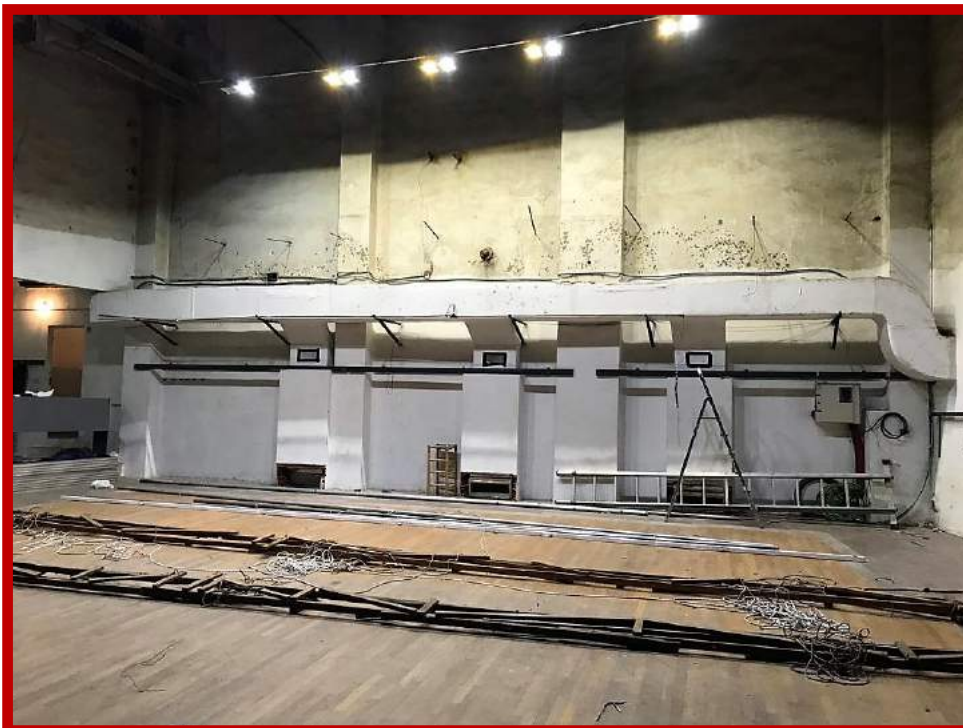
Interior de l'escenari amb els antics pilars que després es reforçaran amb una armadura de ferro.
